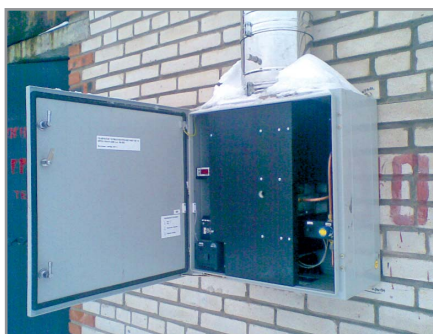
Рис. 14. Генератор ТЭГ-15 на газораспределительном пункте
