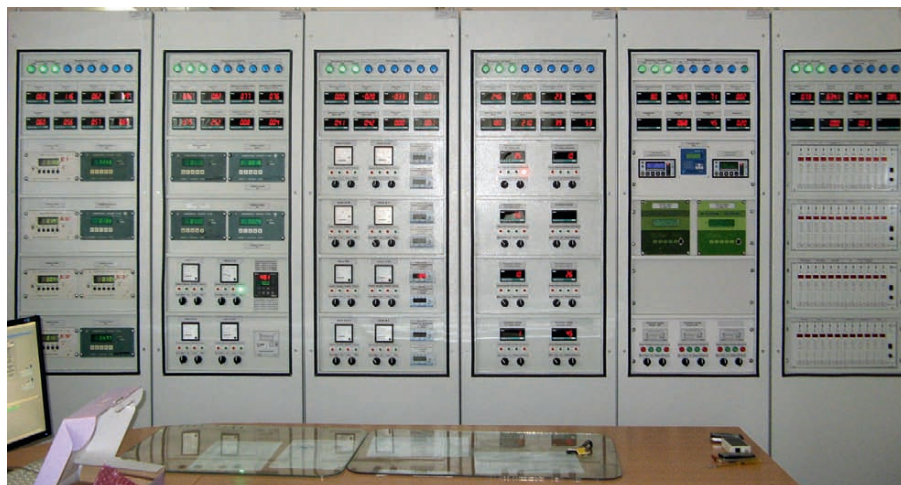
Рис. 2. Операторная ДНС Западно-Бурейкинского месторождения
