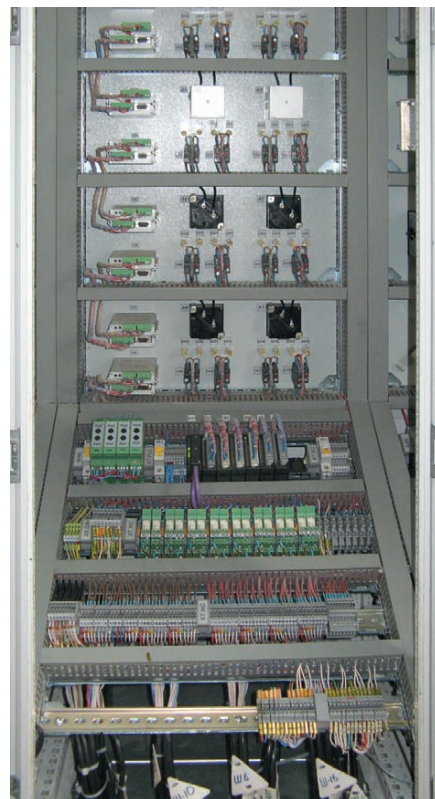
Рис. 4. Секция контроля и управления электродвигателями
