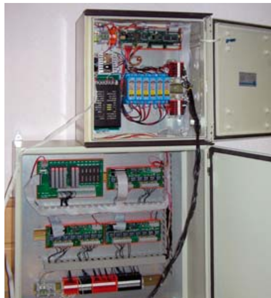
Рис. 2. Блок контроллера БСУ
