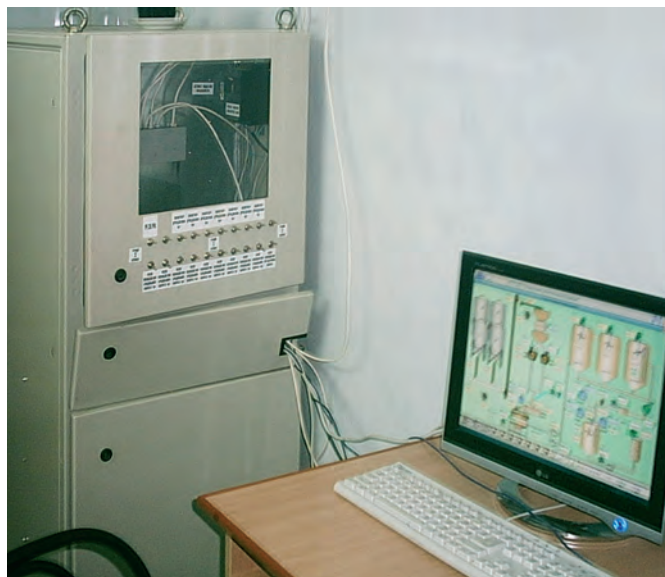
Рис. 6. АРМ оператора дрожжебродильного и варочного участков и стойка управления
