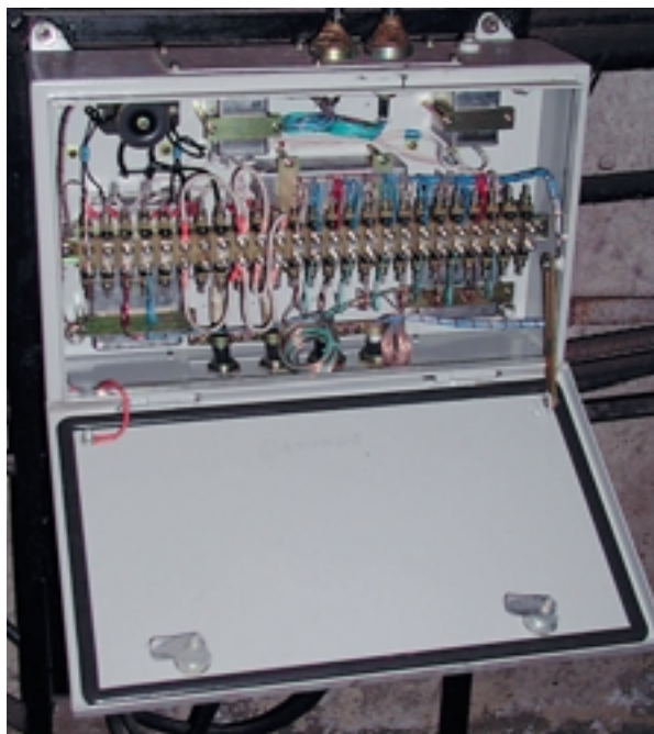
Рис. 11. Трансформаторный ящик (ТЯ) в тоннеле
