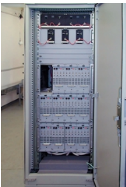
Рис. 8. Стойка СТФ аппаратуры ФМ-канала
