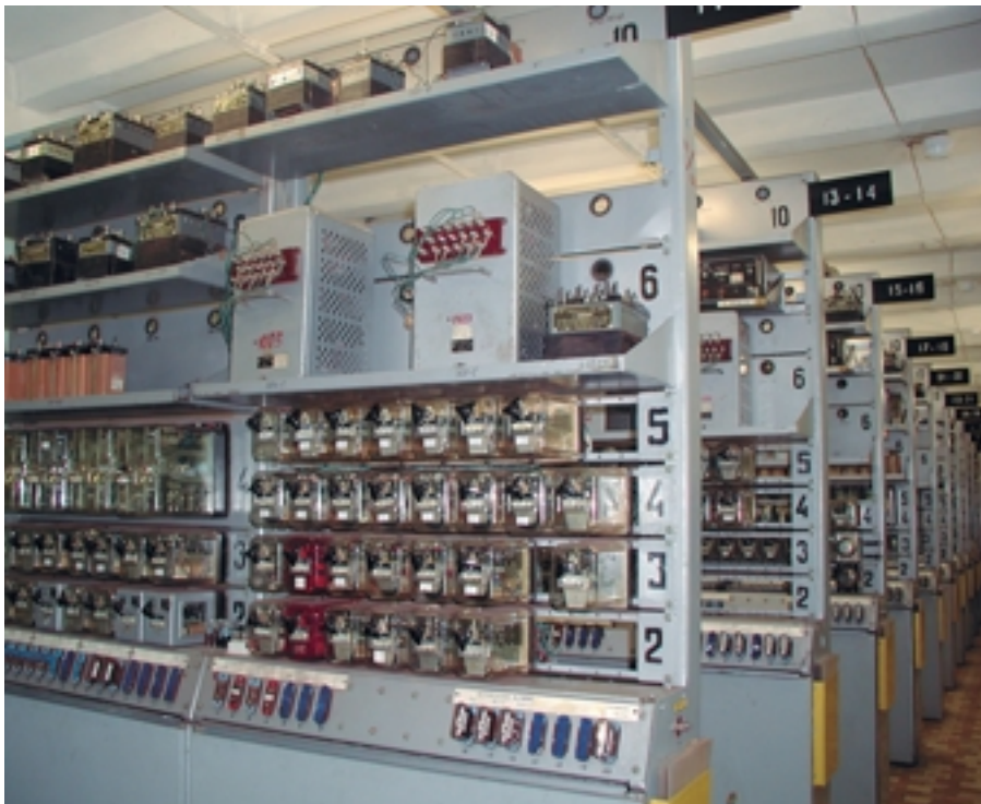
Рис. 2. Общий вид помещения АТДП (аппаратуры телемеханики и управления движением поездов) со старым оборудованием (зона ответственности — около 500 м пути в пределах станции и 3 стрелки)
