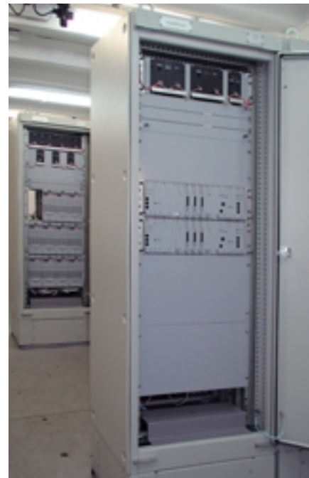
Рис. 3. Общий вид помещения с новой аппаратурой (зона ответственности — около 2,7 км пути и 3 стрелки)
