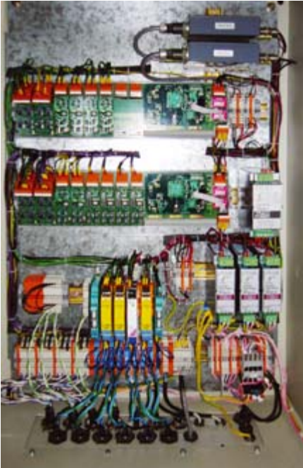
Рис. 6. Размещение аппаратуры регистрации данных и управления в электротехническом шкафу
