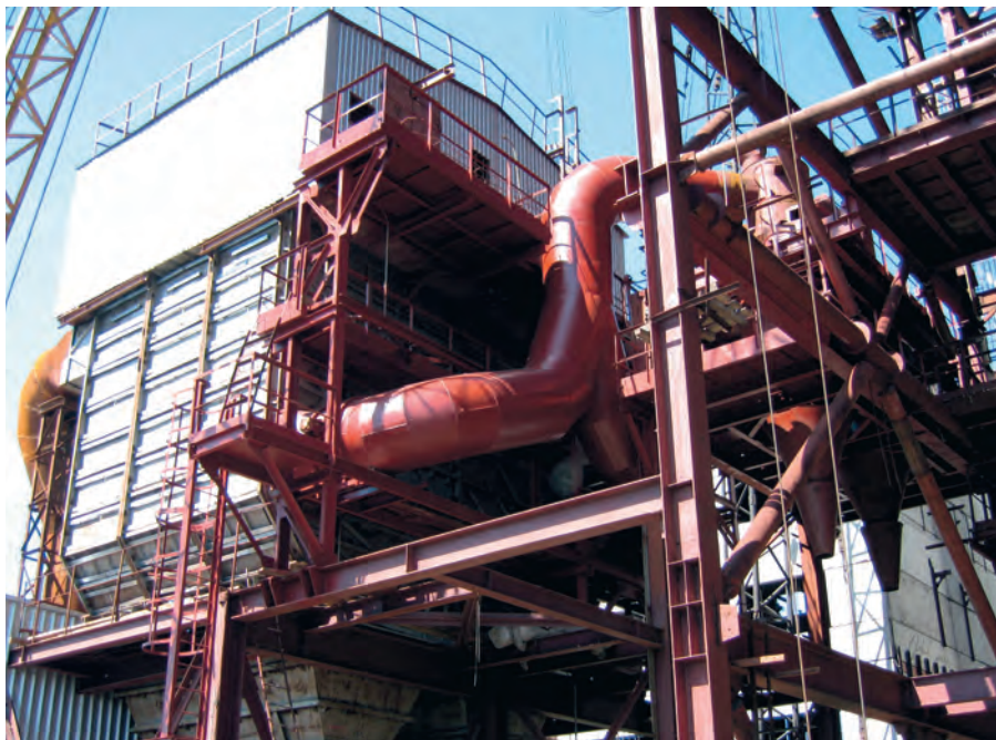
Рис. 1. Фильтр ФРИР 800х2 (ОАО «Алчевсккокс»)
