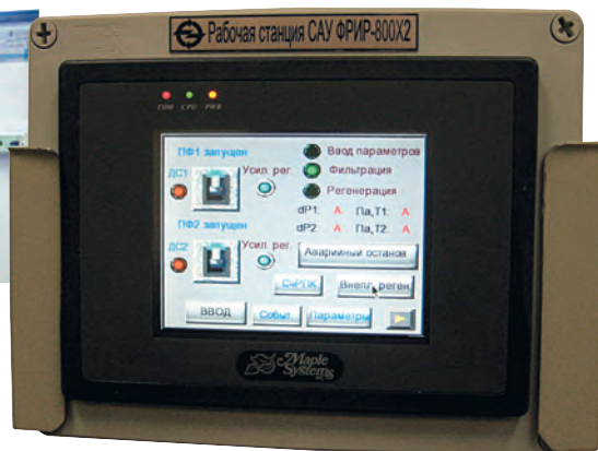
Рис. 5. Рабочая станция САУ ФРИР 800x2 с главным видеокладом
