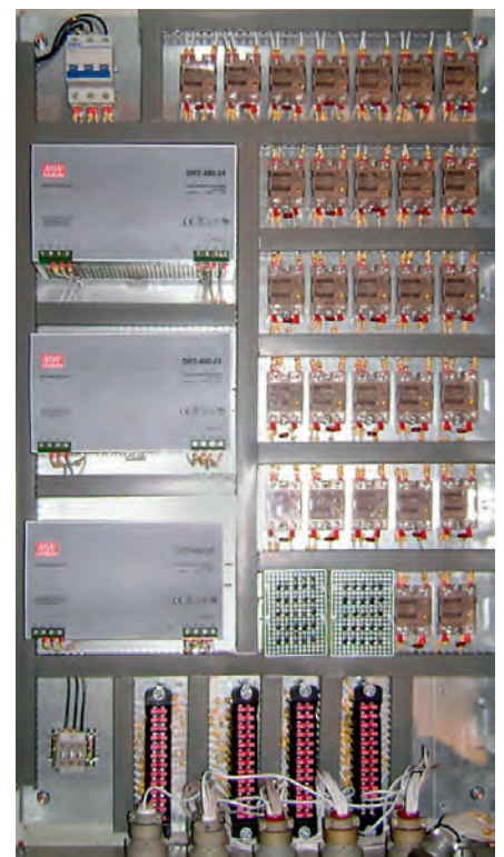
Рис. 5. Блок бесконтактной коммутации панели ПЛК
