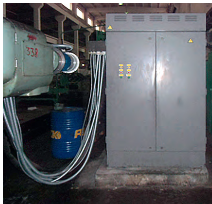
Рис. 1. Внешний вид шкафа управления с элементами привода оси Z
