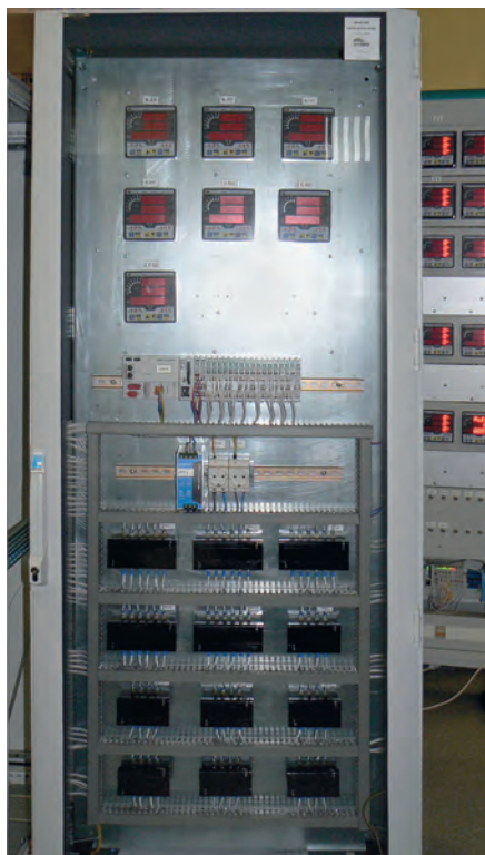
Рис. 4. Шкаф Rittal с датчиками телеизмерений SATES и контроллерами WAGO I/O для Ленинградской АЭС
