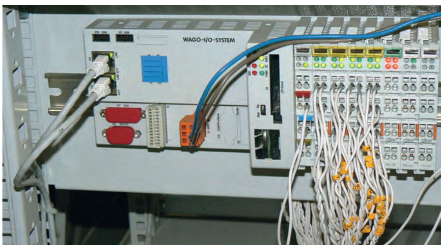
Рис. 3. Контроллер WAGO I/O, смонтированный в шкафу Rittal, для Калининской АЭС
