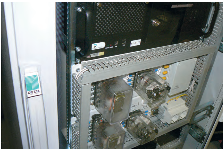
Рис. 2. Шкаф Rittal с цифровым регистратором аварийных процессов «Парма» для Смоленской АЭС
