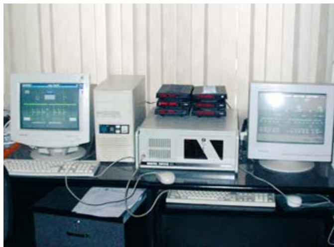
Рис. 4. Оборудование АРМ инженера АСУ
