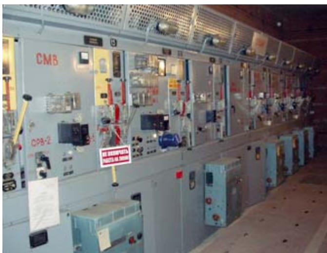
Оборудование распределительного пункта (РП)
