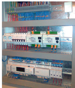
Рис. 3. Щит управления ИТП
