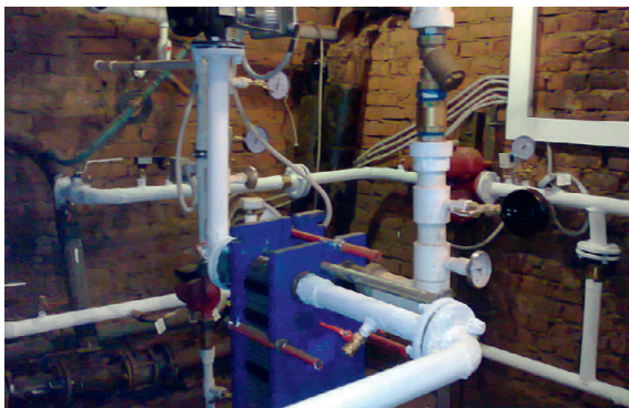
Рис. 2. Индивидуальный тепловой пункт
