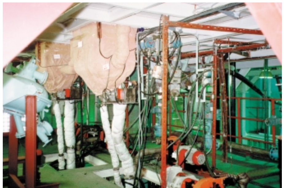
Рис. 6. Так выглядит узел подготовки шихты
